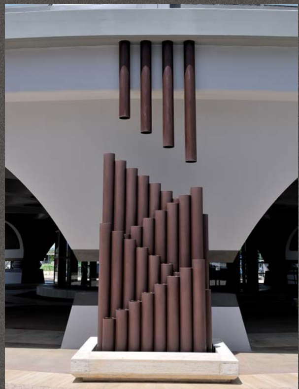
Particolare del sistema di raccolta dell’acqua piovana Detail of the rainwater collection system
